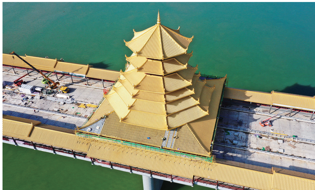
11月24日,工人在柳州凤凰岭大桥风雨亭上铺设铜瓦(无人机照片)。近日,广西柳州市凤凰岭大桥进入施工冲刺阶段,工人们正加紧施工,即将完成铜瓦铺设的大桥仿佛披上一层金色的外衣,成为柳江上一道靓丽风景。新华社发(黎寒池 摄)
