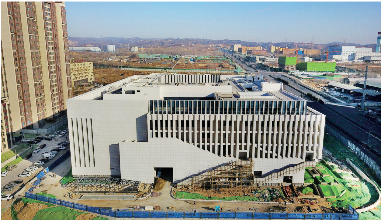
12月22日,山西省档案馆新馆建设项目正在有序推进,总建筑面积5万余平方米,建成后,将成为我省智慧化档案文化服务中心。
