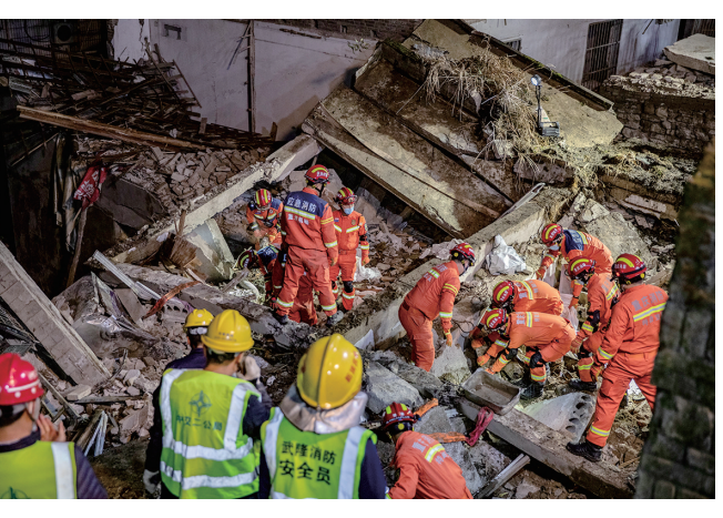
1月7日，在重庆市武隆区凤山街道办事处食堂坍塌现场，救援人员在进行救援。新华社发
