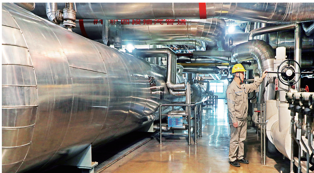
2月4日,太原第二热电厂职工坚守在保供保电一线,为千家万户送去光明与温暖。图为值守职工在生产现场检查设备运行情况。李学军 高爱丽 摄
