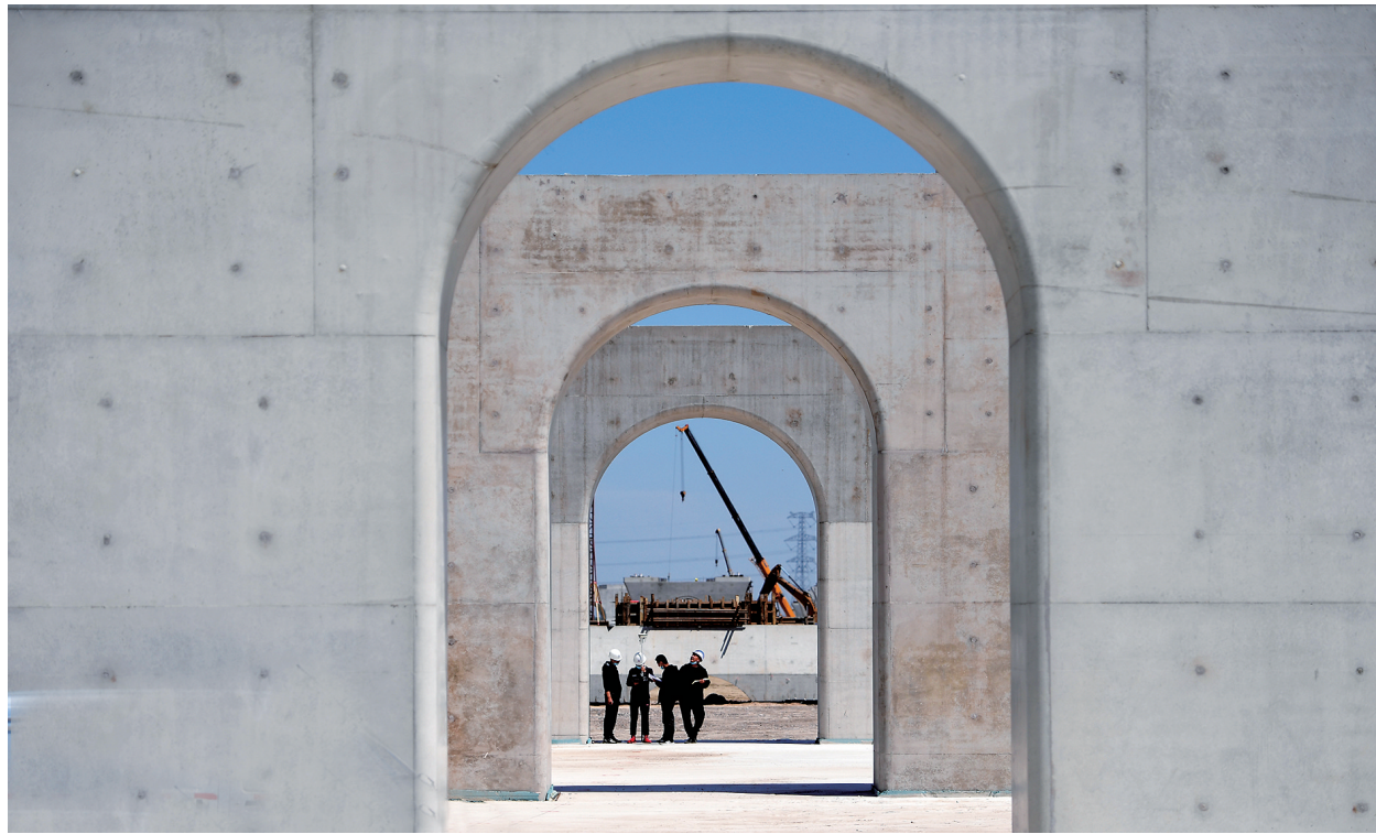
5月1日,滨河东路南延二期工程工地上,建设者坚守一线,快马加鞭全力推进工程建设。该工程北起迎宾路,南至清徐县文源路,全长15.8公里。建成后,对于完善城市交通路网、带动南部区域快速发展具有重要意义。米国伟 摄
