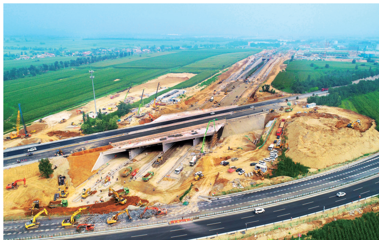
8月3日,由中铁十二局集团承建的太忻大道(太原段)第四标段重要节点——下穿二广高速涵洞施工顺利完成,标志着太忻大道(太原段)主线即将全线贯通。 赵世凯 赵桂军 摄
