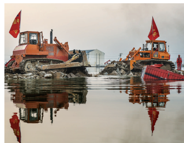
8月6日，抢险人员在溃口处进行封堵作业。经现场抢险人员连续5天奋战，辽宁绕阳河溃口封堵完成合龙。至此，发生在辽宁省盘锦市域内的绕阳河左岸曙四联段溃堤抢险取得重大进展。
