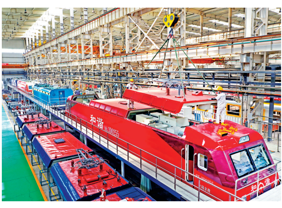
中车太原公司和谐型机车总组装机生产线上，工人们吊装电力机车顶盖。 米国伟 摄
