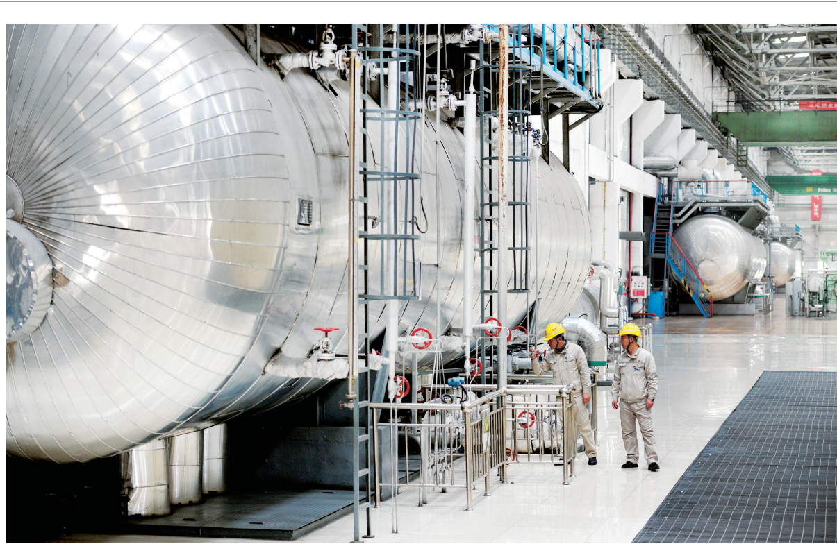
11月2日，大唐山西发电有限公司太原第二发电厂的技术人员正在对运行设备进行检查，全力保障我市冬季供热。牛利敏 宋卫东 摄
