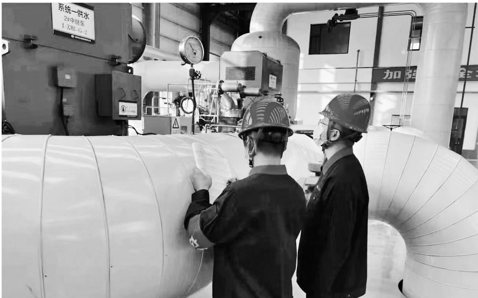
工作人员记录入网及回水水温、二级管网补水水量等。
