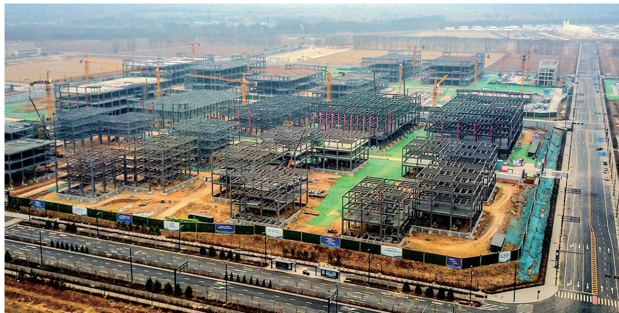
经过建设者的艰苦奋战,1月11日,太忻一体化经济区大孟产业园标准化厂房项目钢结构主体完成,为后续工程的进行打下基础。 牛利敏 宋卫东 摄
