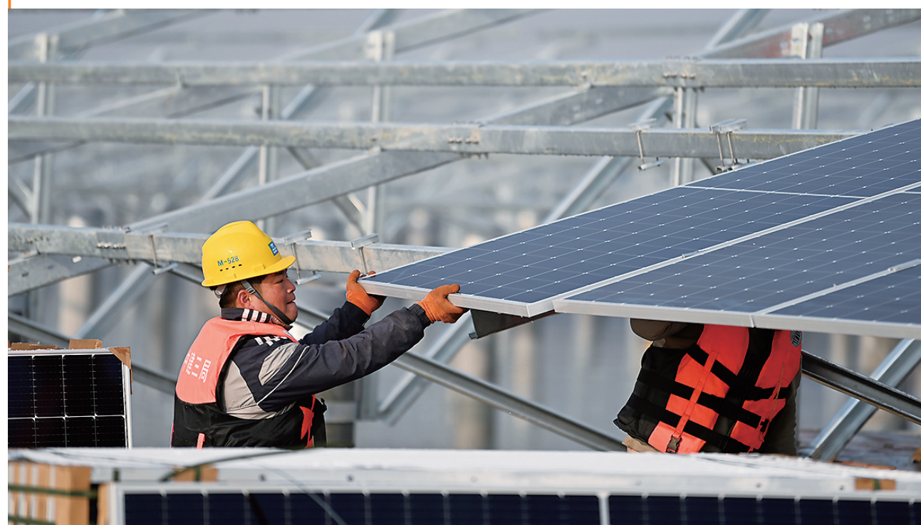
2023年1月5日，建设者在华电海晶光伏项目B标段施工。由中建三局总承包公司承建的天津华电海晶1000兆瓦“盐光互补”光伏发电项目建设稳步推进，项目预计在4月建成完工。新华社记者李然摄
