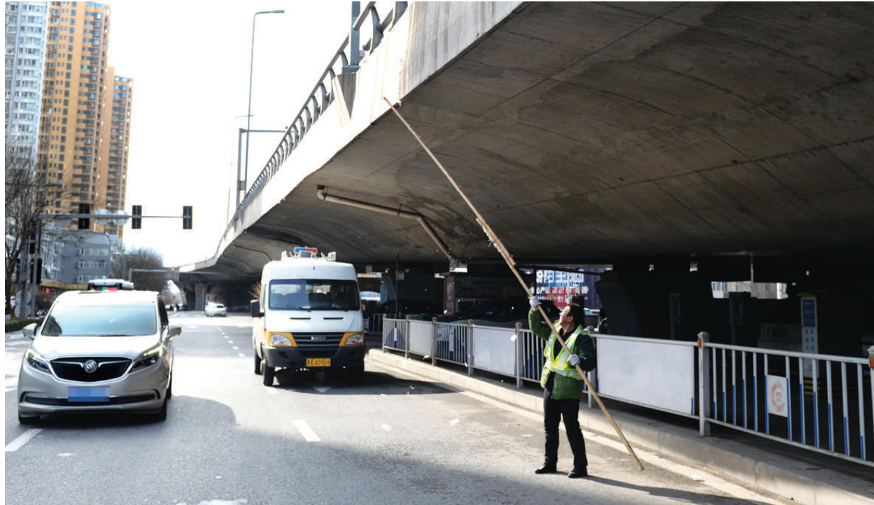
连日降雪给城市的交通设施带来安全隐患。2月13日，市政人员对建设路高架桥下的冰挂进行清理，保障市民安全出行。
