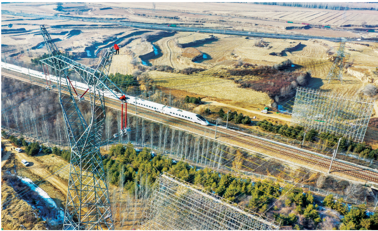
3月1日,随着阳曲县大方山村段的电网改造完成,我省电网首条智慧输电线路——500kV侯阳I线跨石大客专技改工程全部完工。宋卫东 王浩 摄
