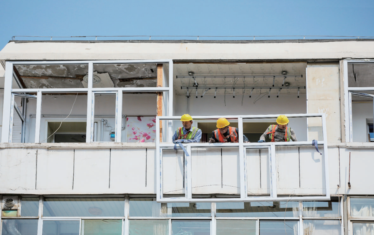
3月17日,太原市节能改造二期项目迎泽区双塔一社区甲字六号楼施工现场,工人正在为住户更换窗户。该工程按照75%的节能标准进行施工,实现节能环保,优化居民居住环境。王韵菲 摄
