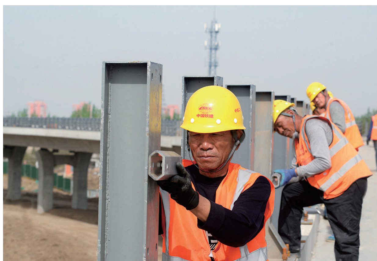
4月17日，由中铁二十二局集团承建的大原武宿机场空港配套项目经北街跨太榆路高架桥主体工程已完工，施工人员正在安装桥面护栏。工程建成后，将增强机场的通行力。 牛利敏 路军华 摄
