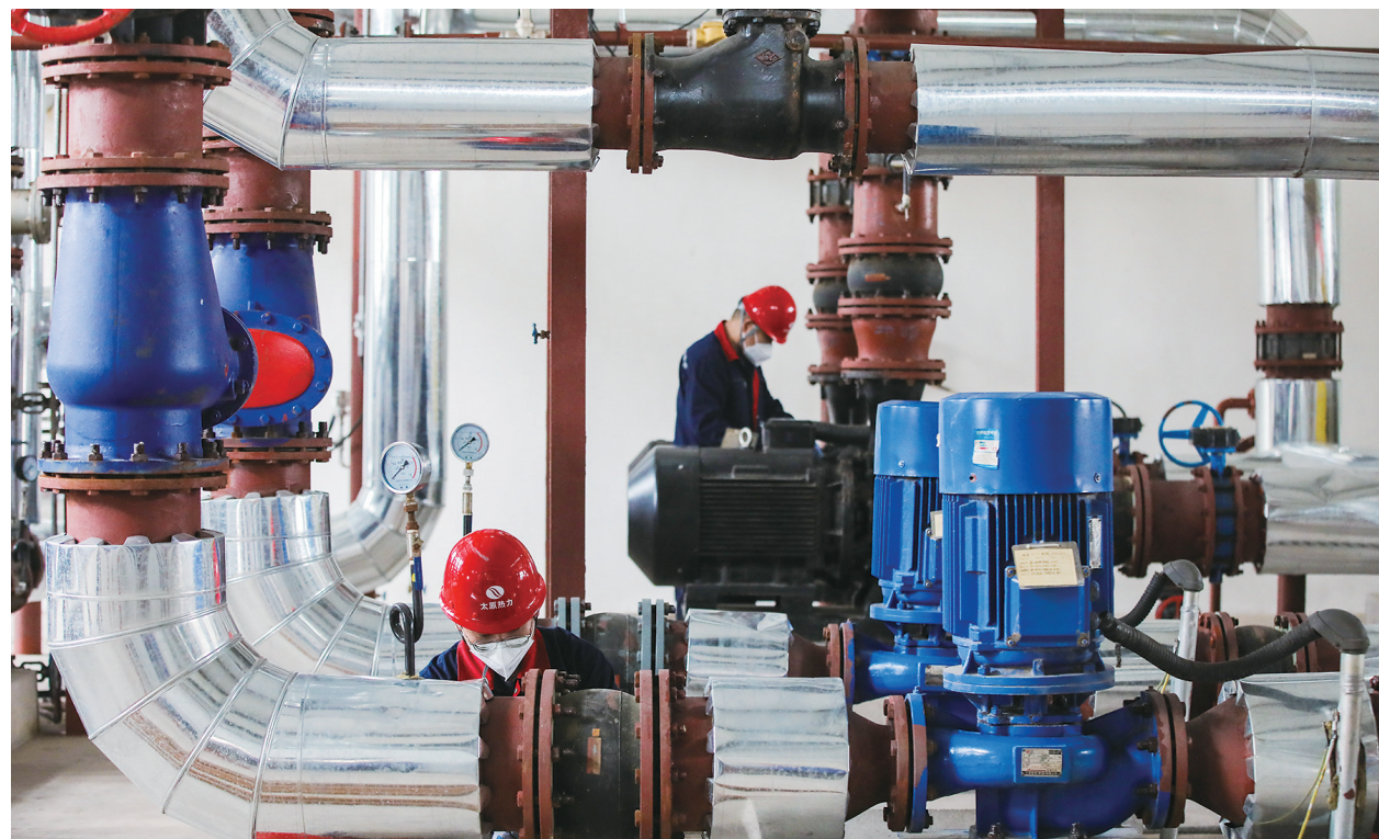
5月29日,太原热力集团晋源公司姚村热力站工人对供暖管路系统进行夏季防腐作业,以保障冬季供暖系统平稳运行。
