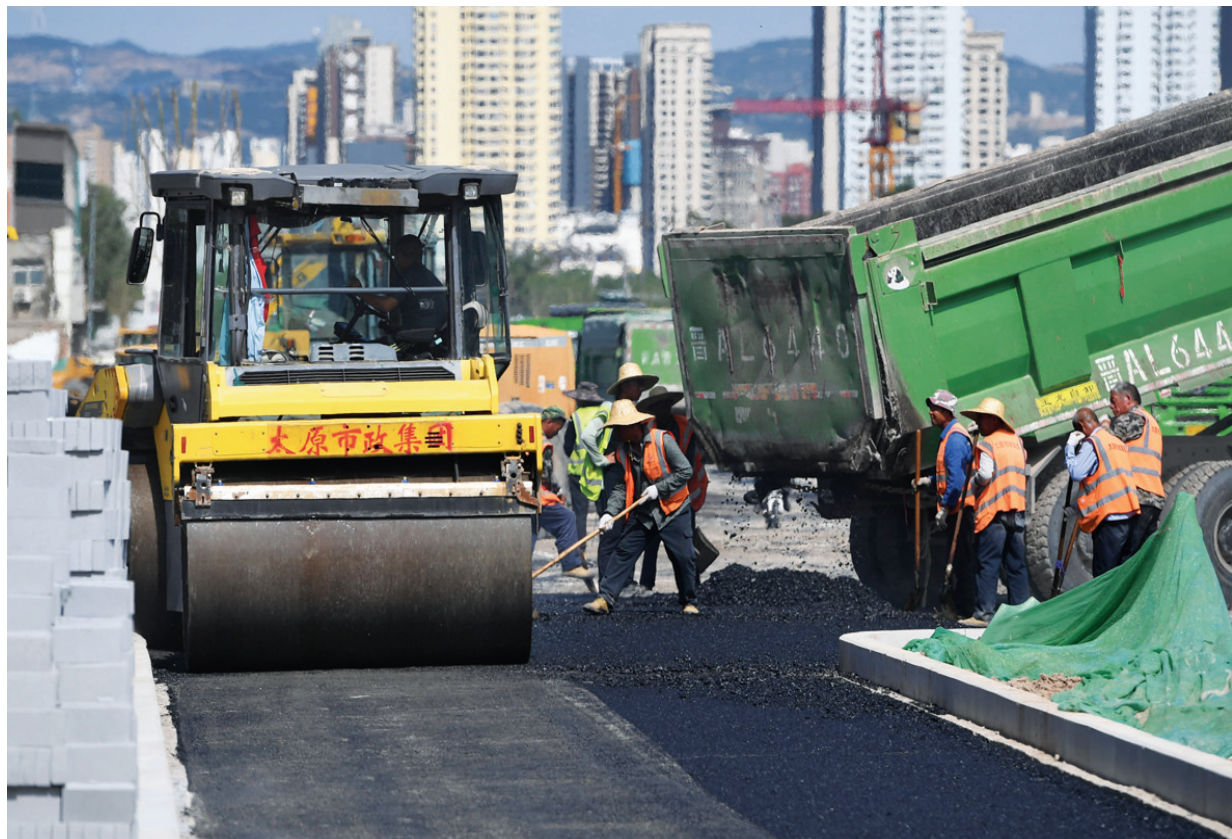
6月4日，兴华街改造工程施工人员正在给路面铺设沥青。该工程2000余米雨水方涵埋设已基本完成，配套设施建设接近尾声。 邓寅明 摄
