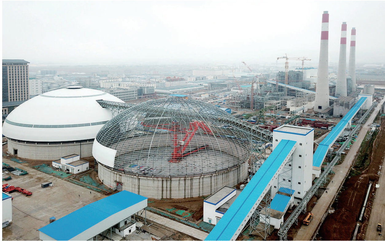
6月12日,山西合成生物产业生态园热电联产项目施工正在有序推进。项目建成后,将有效保障园区工业生产热需求。牛利敏 宋卫东 摄
