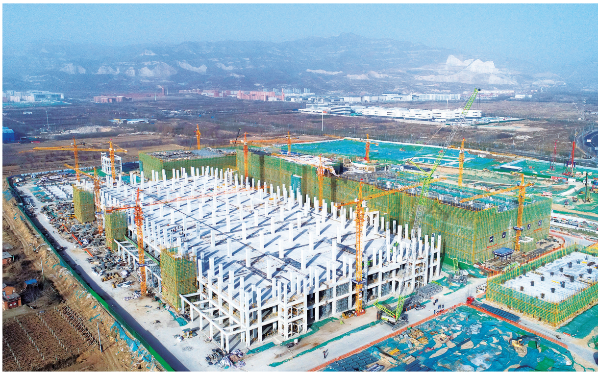
12月9日,中北高新区上兰新材料园区标准化厂房及配套基础设施项目在加紧建设。该项目占地面积220余亩,经过8个月的奋战,目前,土地强夯、三通一平、桩基工程及主要建筑单体基础施工已经完成,进入主体框架安装阶段。赵世凯 摄
