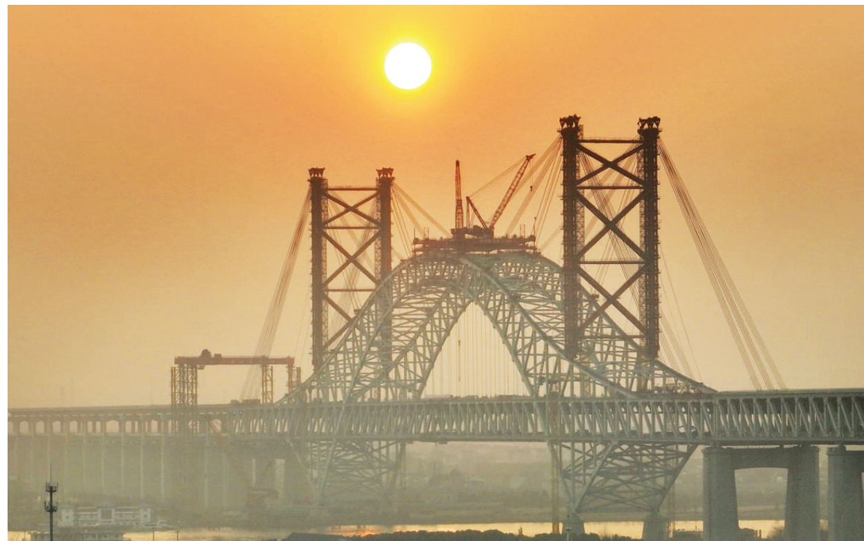
1月12日拍摄的位于江苏省常州市的常泰长江大桥安洲专用航道桥(无人机照片)。
