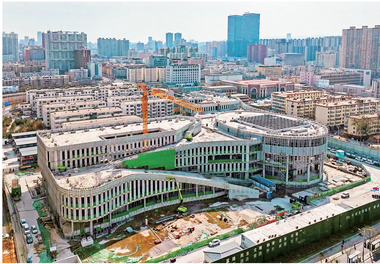
3月17日,杏花岭区文化活动中心项目正在加紧建设。各承建单位精细化制订全年建设计划,安装工程、装修工程、幕墙工程有序推进,景观工程、市政工程和智能化工程已完成前期准备工作。 赵世凯 孙嘉奇 摄
