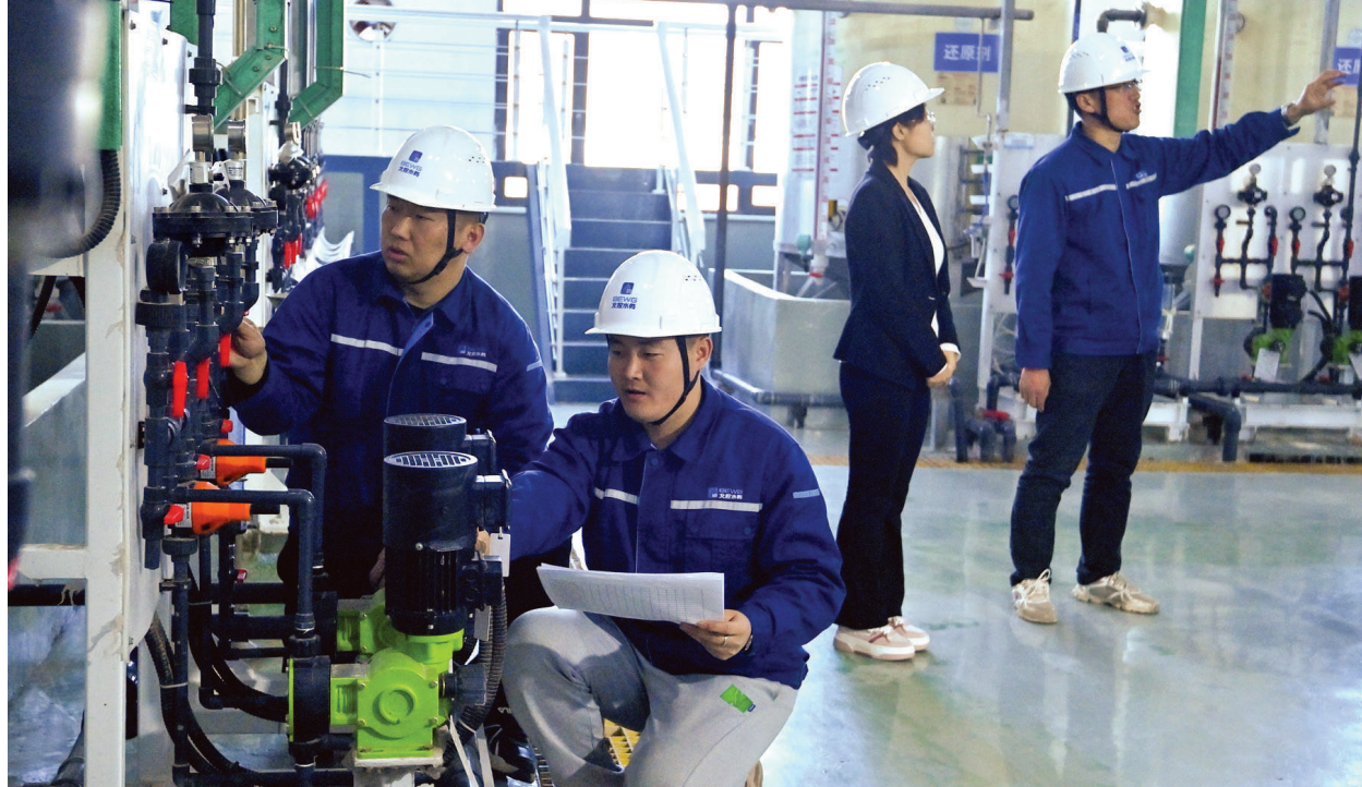
3月26日,位于晋源区姚村镇的太原市再生水综合利用示范基地的工作人员各司其职,确保我省大型工业企业高品质用水供应稳定。据了解,该基地占地面积约1.25万平方米,通过“超滤+反渗透”双膜工艺,发挥再生水资源优势,助力我市能源双控与双碳转型。牛晨阳 摄
