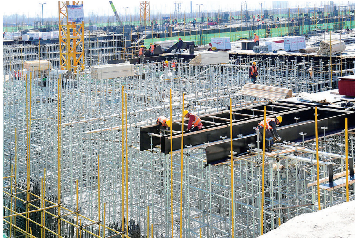
3月30日，山西太原高性能制造技术与智能应用升级中试基地建设项目正在加紧施工。中铁十二局集团施工团队精准施策、合理调度，全力推进项目建设。目前，钢结构厂房、传感器厂房以及配套楼已进入地上主体结构施工阶段。 赵世凯 屈丽霞 摄影报道
