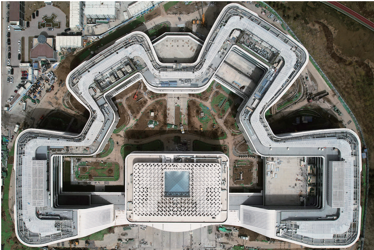
这是位于雄安新区启动区内的中国星网总部大楼建设现场（3月28日摄，无人机照片）。
