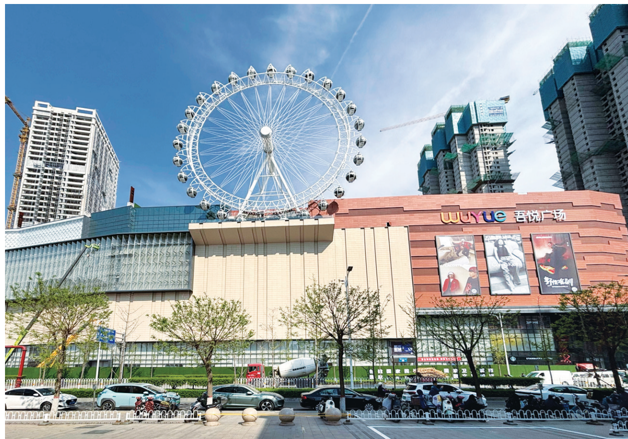
4月10日,万柏林区吾悦广场建设项目正在收尾中。该项目建成后不仅方便周边市民的休闲购物需求,更提供上千个就业岗位。
