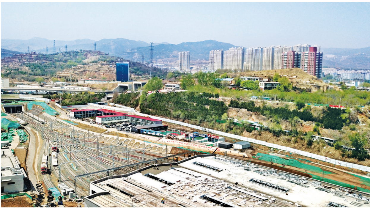
4月20日,太原轨道交通1号线西山停车场,在保安全保质量的前提下,施工人员紧张忙碌着,加快施工进度,确保如期交付使用。
