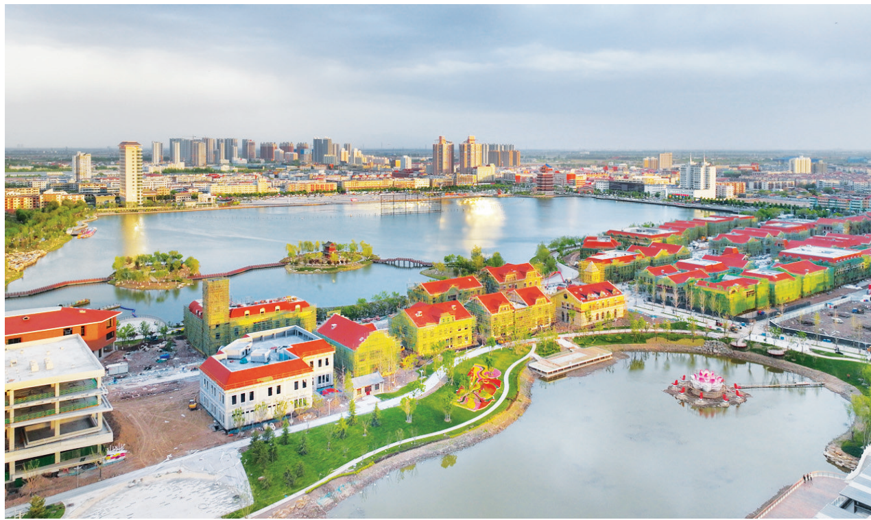
4月22日,清徐县清源水城建设现场,施工人员正在全力冲刺。据了解,该项目占地面积1600余亩,建成后将成为集文化、旅游、休闲、商业、美食为一体的综合区域。张昊宇 陈博敏 摄影报道
