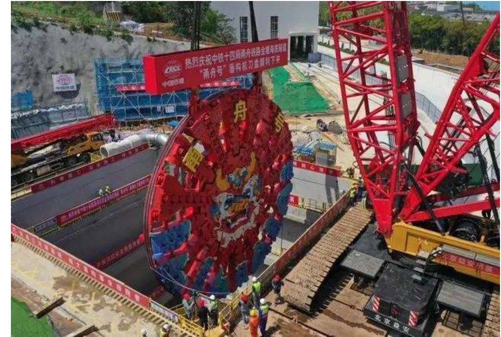
4月18日，“甬舟号”盾构机刀盘被吊运至甬舟铁路金塘海底隧道宁波侧盾构始发井(无人机照片)。
