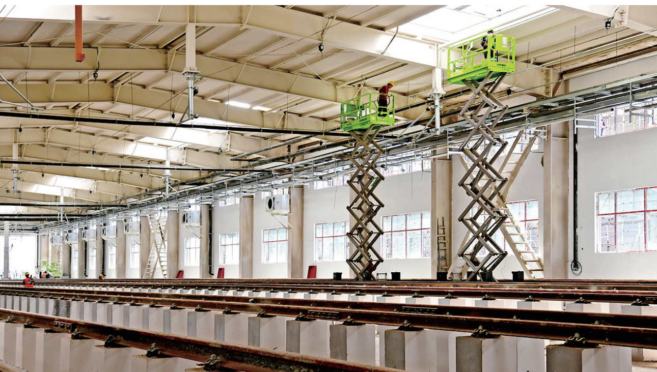
5月3日,太原地铁1号线马练营车辆段项目工地,建设者正在运用库内施工作业。目前,该项目地基基础及主体结构已全部完成,二次结构完成95%,装饰装修完成78%,其他施工按计划稳步推进。赵世凯 马薇 摄影报道
