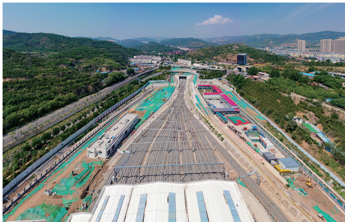
6月28日,太原地铁1号线西山停车场建设工地,土建工程全部施工完成,各单体装饰装修工程进入收尾阶段,室外工程稳步推进,为全线联调联试做好保障。
