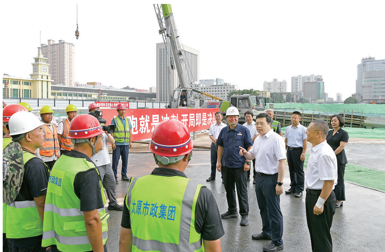
省委常委、市委书记韦韬在迎泽大街火车站区域施工工地调研改造情况,慰问一线建设者。
