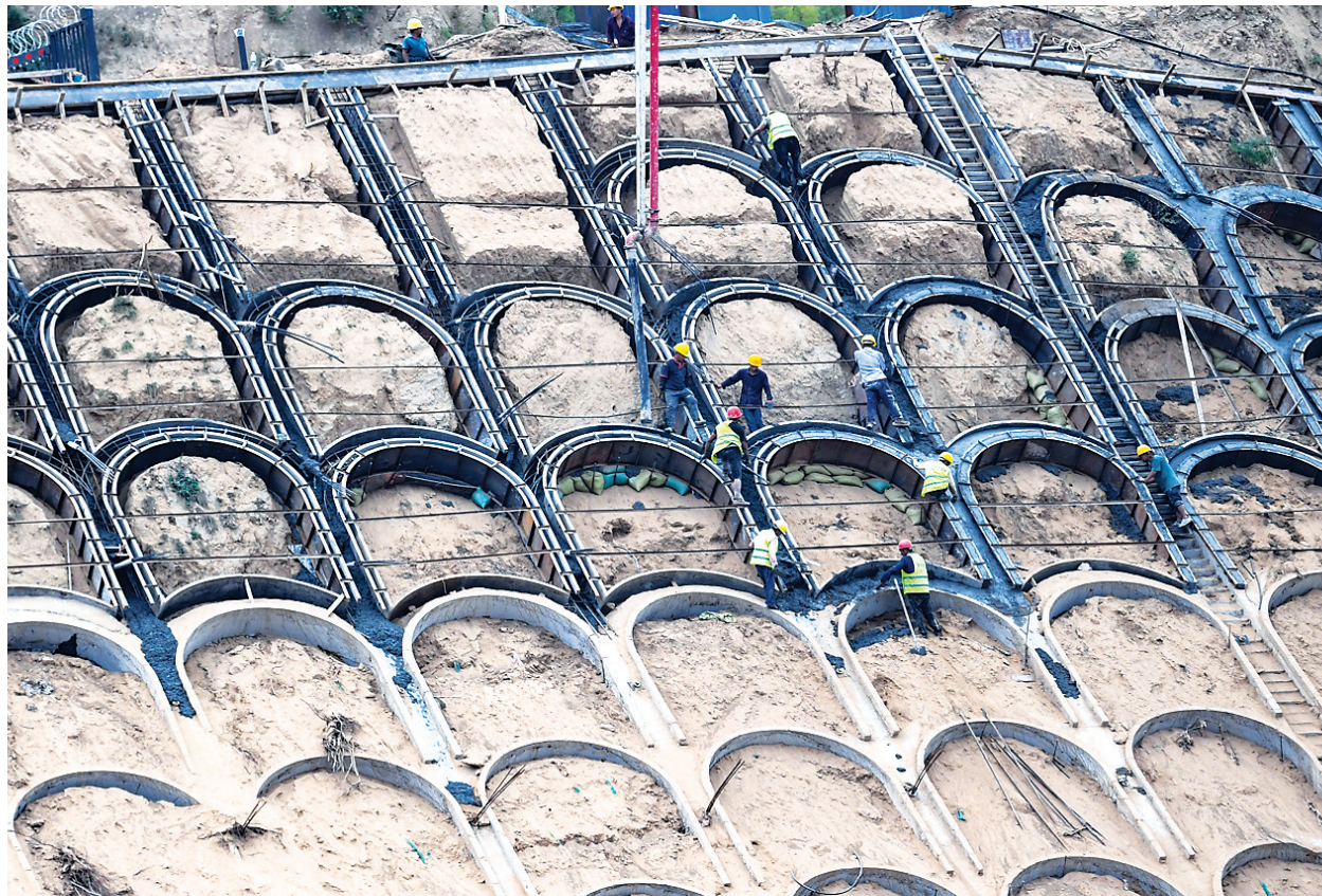
8月25日,尖草坪区老龙头区域生态治理工程(三期)项目加快推进,施工人员正在加固护坡。老龙头项目北起汾河出水口,南至汾河一坝下游滚水坝,东起滨河东路,西至土堂村,工程内容包括汾河水利整治和生态修复等。改造完成后,将全面提升老龙头一带的生态颜值,与汾河四期融为一体。
