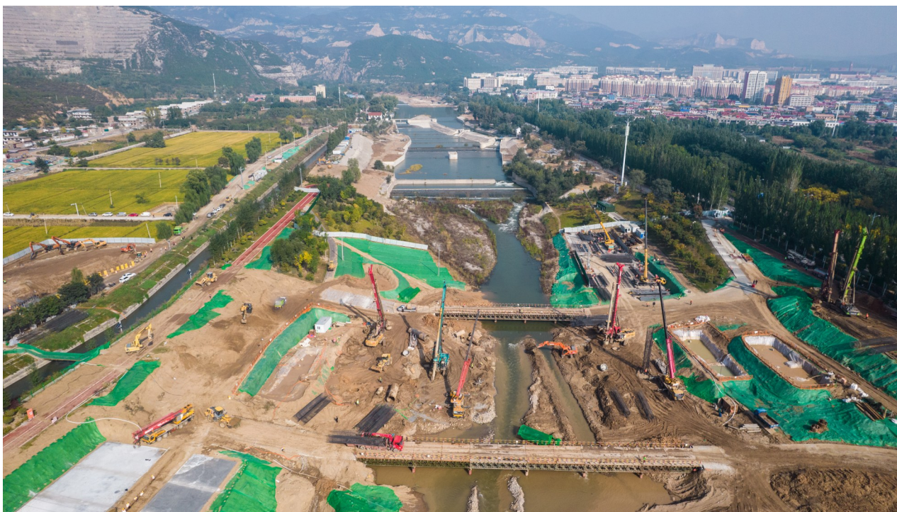
10月16日,幸福桥建设现场,太原市政集团正紧锣密鼓地施工。该工程设计为一座跨汾河大桥,西起净因寺广场前,东至滨河东路。建成后,将进一步完善省城交通网络,提升城市形象。 王韵菲 摄
