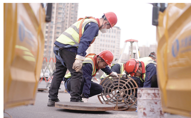
供暖以来，工作人员进一步加强对热力管线、热力站、热力井室的巡检，确保设施设备能够正常运行。
