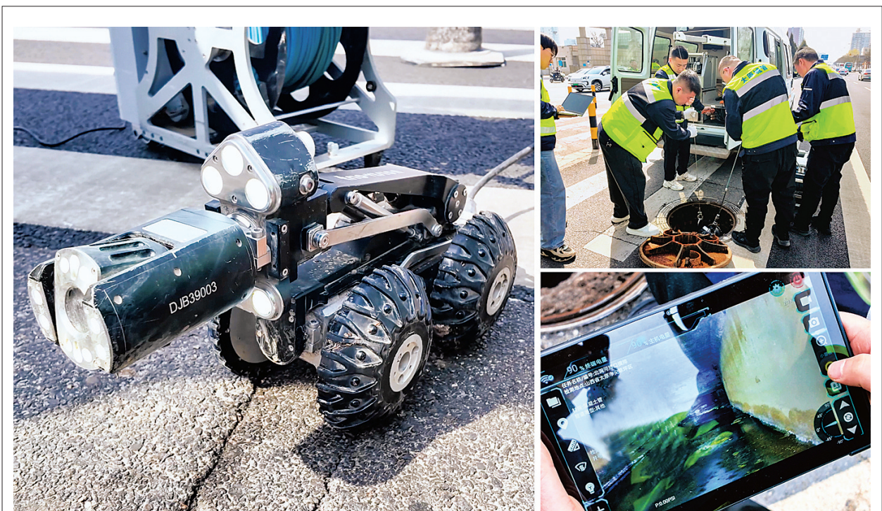
3月24日,市市政建管中心的工作人员在尖草坪区北涧河排水口利用智能机器人进行排查。机器人深入管道内部,将管壁的破损、淤积情况实时传回地面,为技术人员精准评估提供数据保障。牛利敏 杨 斌 摄影报道
