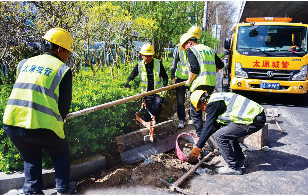
4月4日,太原市政建管中心工作人员在更换建设路狄村街路口破损、歪斜的道路侧石。连日来,太原市政建管中心各道排保队伍以“绣花功夫”推进设施精细化养护工作,派出17个作业队,对前期排查的滨河东路、北中环街、文兴路等25条主干道、快速路侧石展开集中修整。 牛利敏 杨斌 摄影报道
