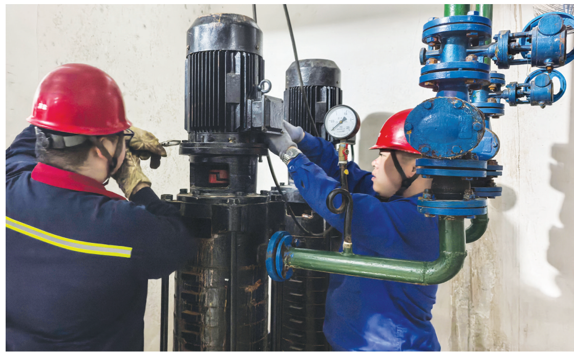
随着气温逐渐回升，太原城管网供热部门抓住供暖结束后的“黄金窗口期”，对辖区内热力站点的设备进行维护保养。图为四月二十日，工作人员正在对一供热站内进行维护。(牛利敏)
