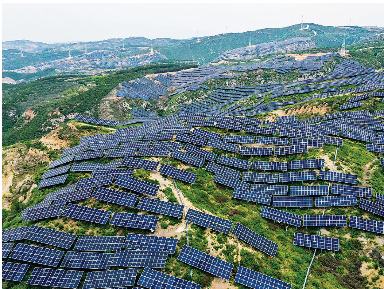
5月9日,杏花岭区中涧河镇洪子峪村附近,395MW(兆瓦峰值)光伏项目一期工程基本建设完成,预计7月将并网发电。该工程建成后,标志着杏花岭区能源结构转型迈出关键一步。牛利敏 郝晨光 摄影报道
