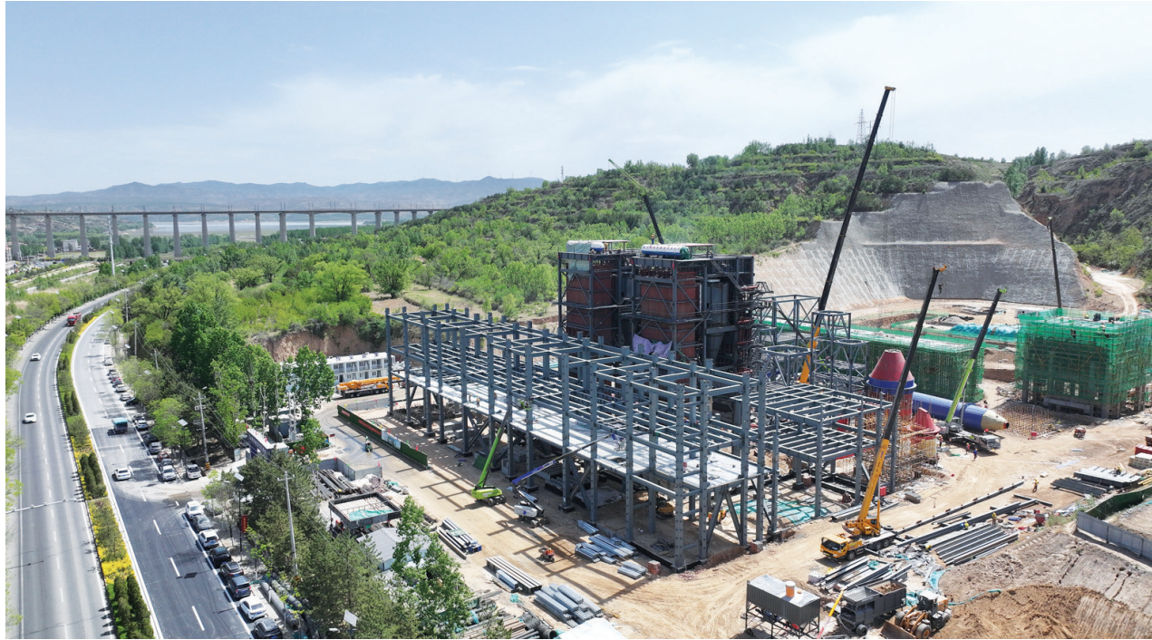
5月10日,娄烦县城集中供热热源厂迁建工程项目现场,机器轰鸣,工程正稳步推进。该项目位于县城东南,占地面积约为22.14亩,计划供热面积为500万平方米。目前,该项目土建基础工程全部完工,主厂房、锅炉间等正在施工中。张昊宇 摄
