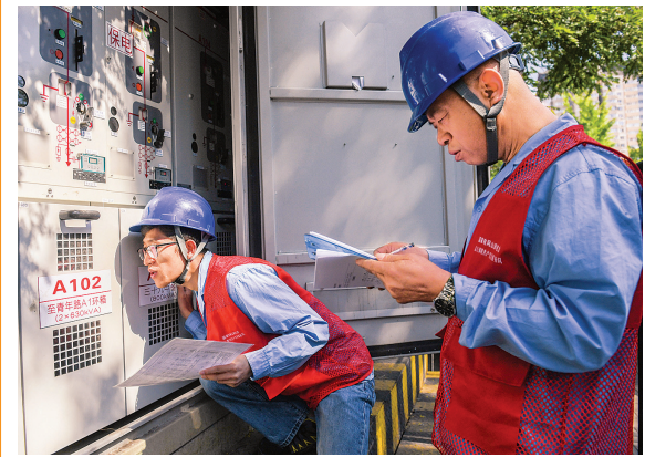
6月8日,国网太原供电公司迎泽中心的工作人员在青年路巡检配电设备。高考期间,我市电力部门加强设备检修和应急预案细化,全力保障高考供电设备安全运行和可靠供电,护航学子圆梦。 牛利敏 摄
