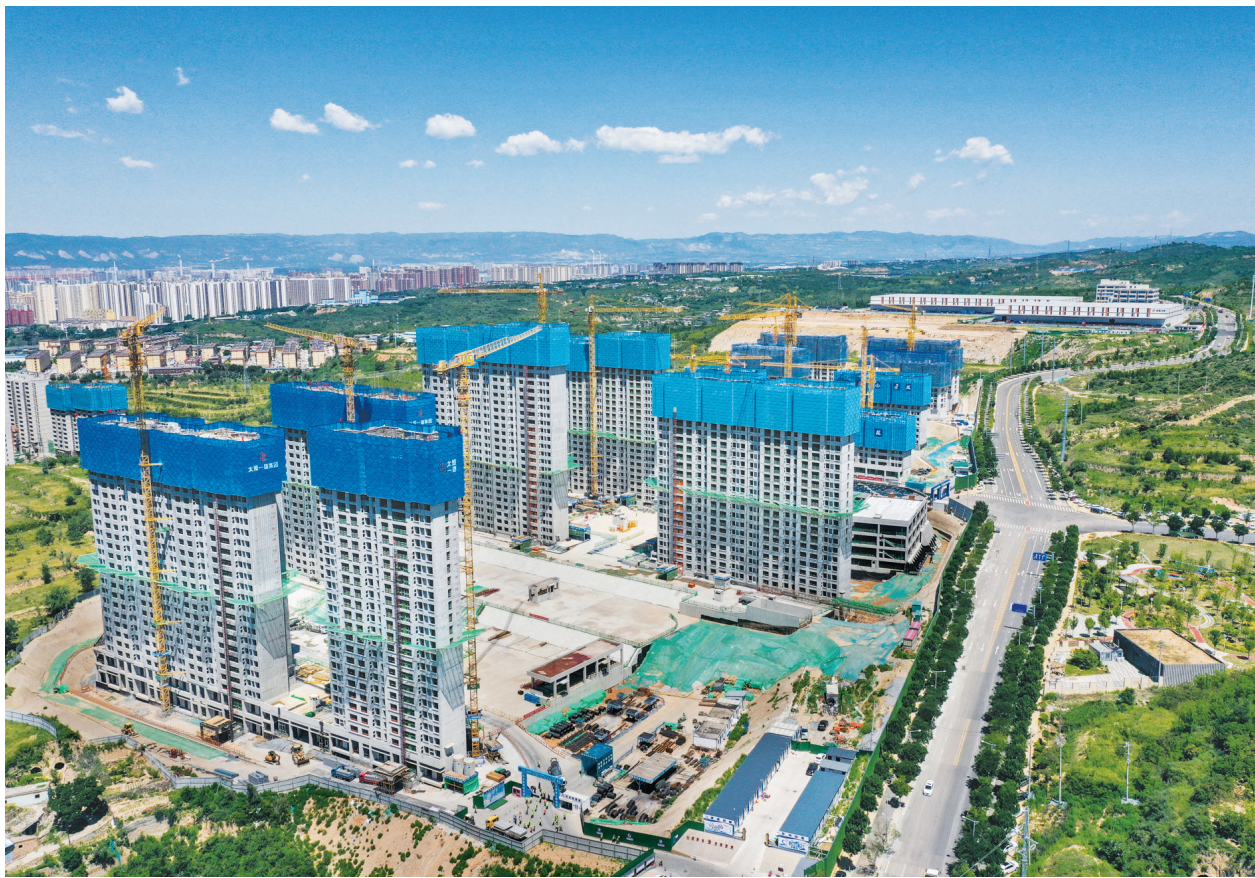
6月11日,杏花岭区杨家峪城中村改造项目有序推进中。该项目建成后,将提升当地居民的生活品质,助力区域经济社会发展。 牛利敏 摄
