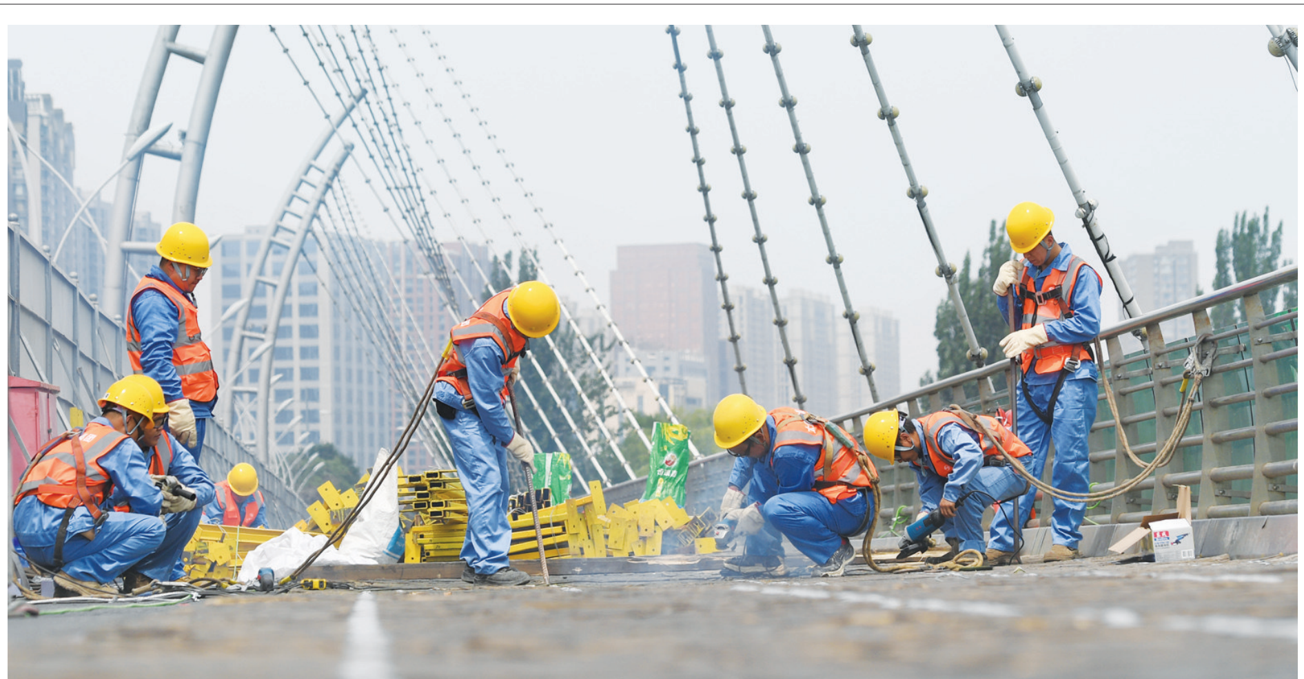
6月23日零时起,由太原市城管局市政建管中心负责实施的南内环桥维修改造工程正式启动。
