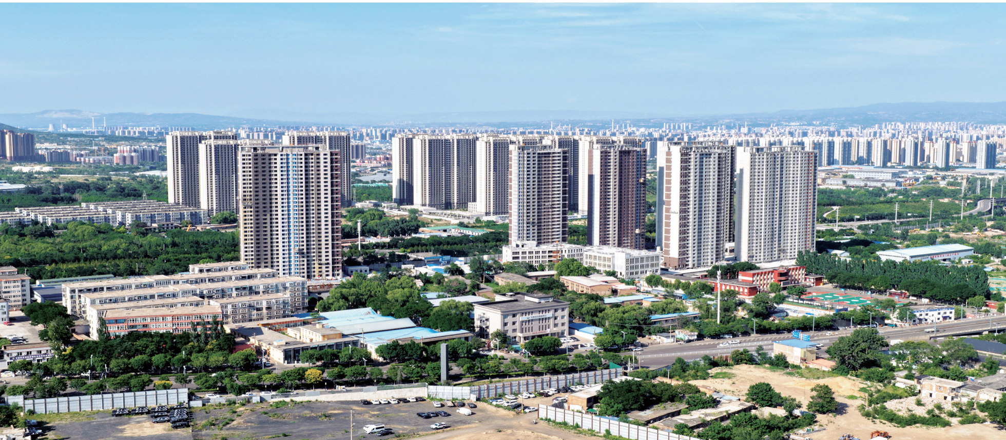
6月25日,新建西铭回迁安置房城中村改造工程项目主体结构已全面封顶。该项目为万柏林区重点民生工程,建成后将提供千余套住宅,改善村民居住条件,完善片区民生配套。王韵菲 摄
