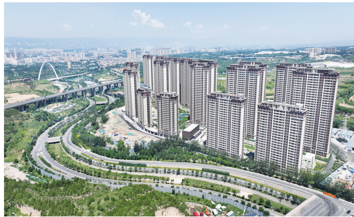
7月5日,杏花岭区重点民生项目——双良水泥厂棚户区安置改造住房项目建筑工地,主体建筑施工已进入收尾阶段,配套设施建设同步快速推进。该项目位于洞河北沿岸与东峰路交叉口,共提供3000余套安置住房。
