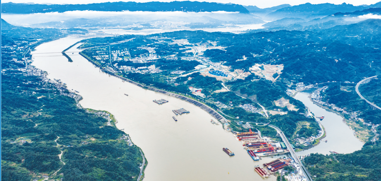
三峡水运新通道工程三峡枢纽新通道施工现场(2026年6月8日摄)。新华社记者 肖艺九 摄
