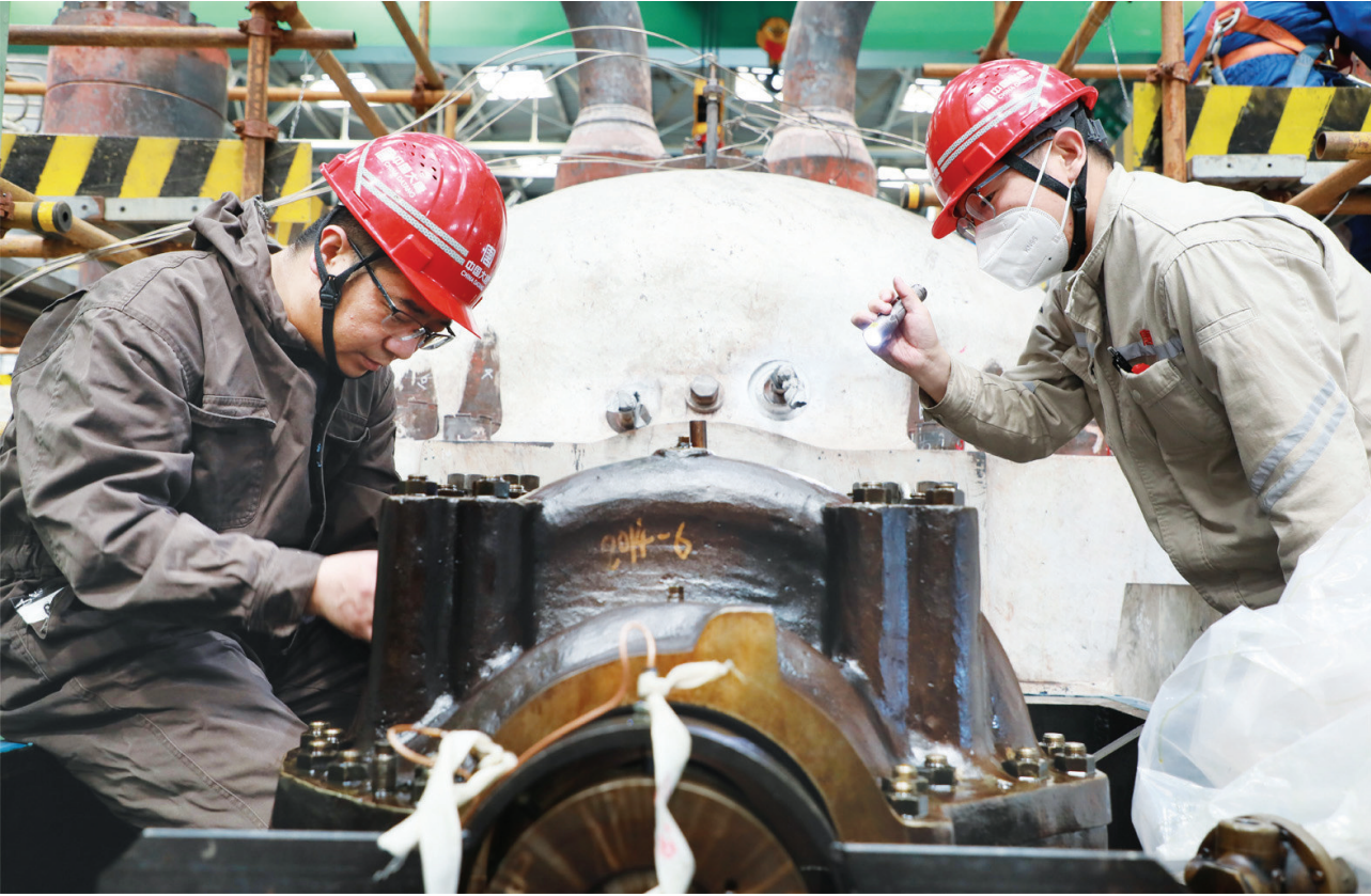
入伏后太原高温持续,用电负荷攀升,迎峰度夏进入关键期。大唐山西发电有限公司太原第二热电厂值班工作人员24小时值守保障机组平稳运转。图为7月29日,工作人员巡检设备。
