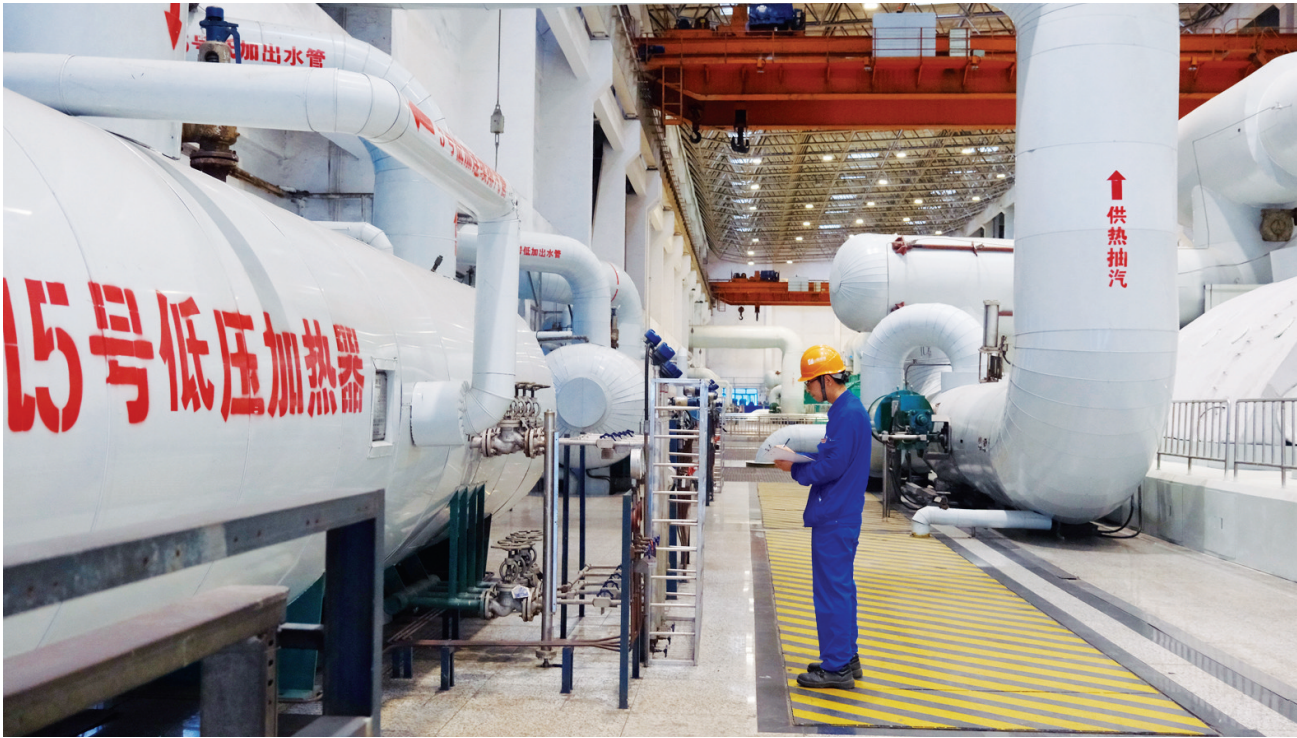
8月5日，山西兴能发电有限责任公司车间内，工作人员巡检机组设备，记录运行参数。该公司紧盯设备运维，做实隐患排查，保障机组安全运行，为地方生产生活稳定用能提供坚实支撑。 王韵菲 摄
