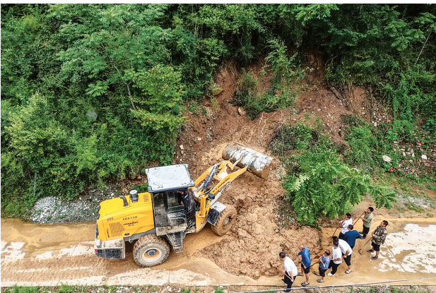
8月1日，在甘肃省陇南市武都区裕河镇范家坪村，干部群众清理一处小型滑坡体(无人机照片)。 新华社记者 郎兵兵 摄
