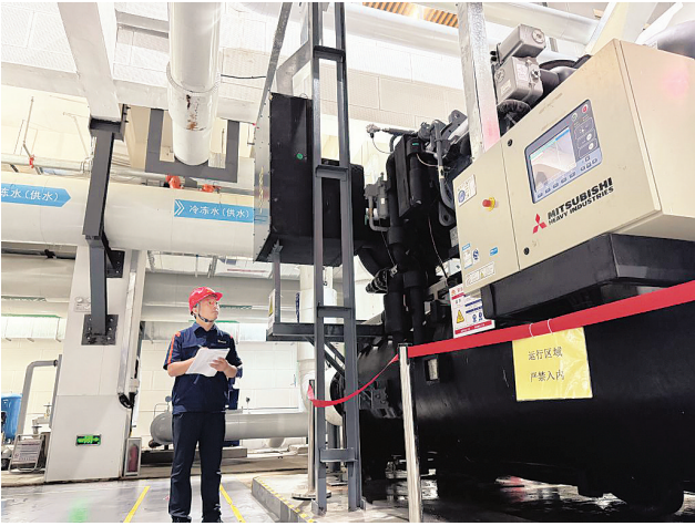
工作人员正在济南能源集团南部能源站巡检设备运行情况。(受访者供图)
